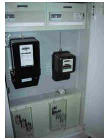
Stromzähler links Verbrauch rechts Einspeisung
