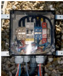
DC-Schaltkasten zur Verschaltung der Module
